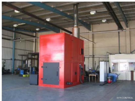
Leistungsmessungen an Biomasse- generatoren und Holz BHKW vor # der Auslieferung
