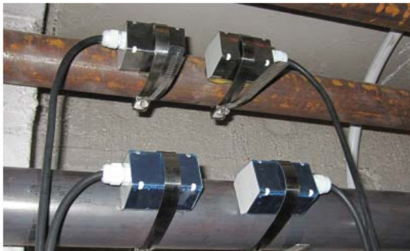
Eingriffsfrei am Rohr
