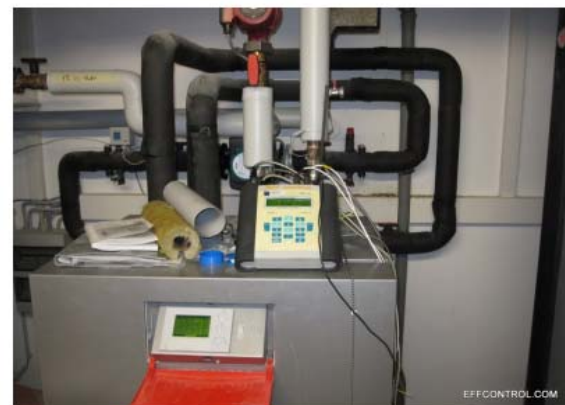
Überprüfungen von Wärmepumpen und Solaranlagen
