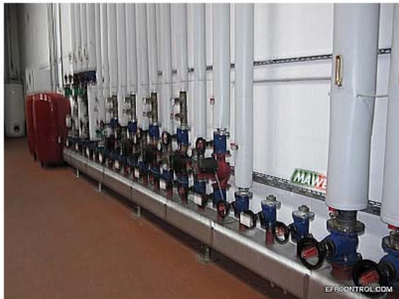
Überprüfung von Hocheffizienzpumpen Hydraulischer Abgleich in Industriehallen
