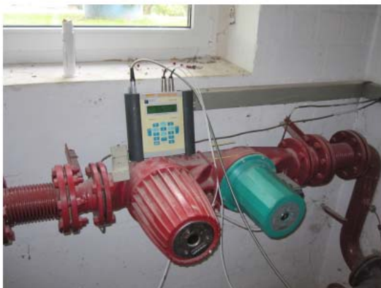
Präzisionsmessungen in Altanlagen : welches BHKW lohnt sich (Dimensionierung)
