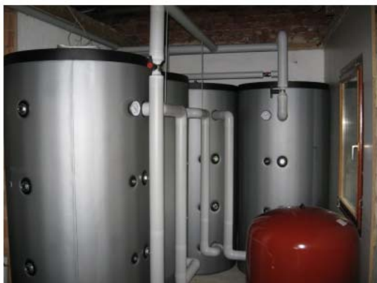
Verlustleistungsmessung an großen Pufferspeicher- anlagen
