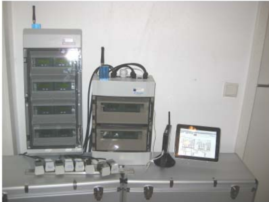
Entwickelte Messstation Ultraschallmehrkannalmessanlage Online 32 Heizkreise
